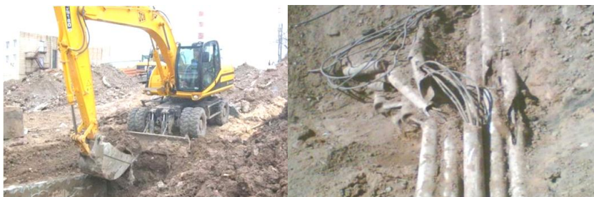
Рисунок 1 - Механические повреждения КЛ
