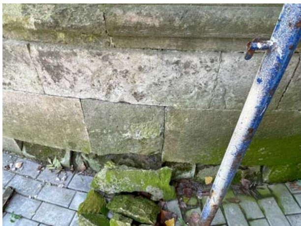
Рис. 5. Внешний вид сколов, выпадение отдельных камней в надземной части, следы увлажнения цоколя
