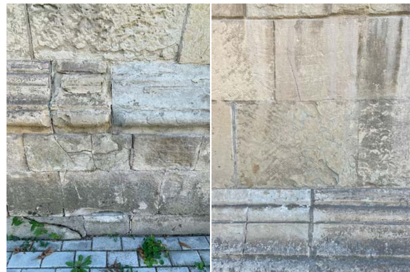
Рис. 3. Внешний вид трещин в цоколе и под окнами
