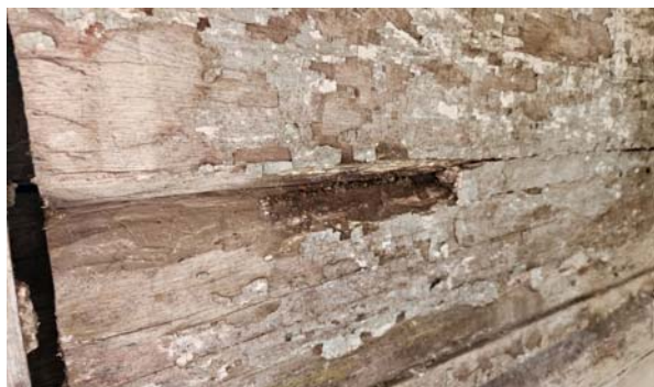
Рис.5. Повреждение древесины насекомыми конструкций Покровского храма в селе Каменка
