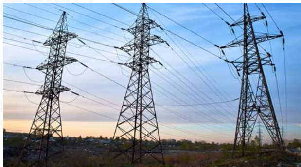
Рисунок 1 – Высоковольтные линии электропередач
