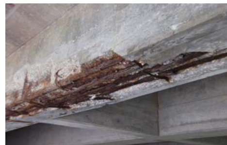
Рисунок 1 – Коррозия бетонных и железобетонных конструкций
