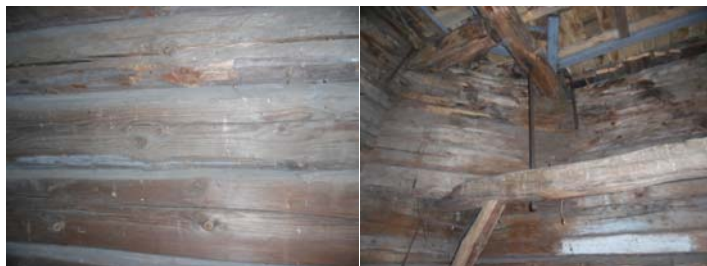
Рис. 4 а) Усушечные трещины древесины сруба; б) Следы замачивания верхней части сруба колокольни
