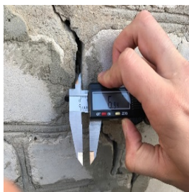
Рисунок 1 - Измерение трещин при помощи штангенциркуля
