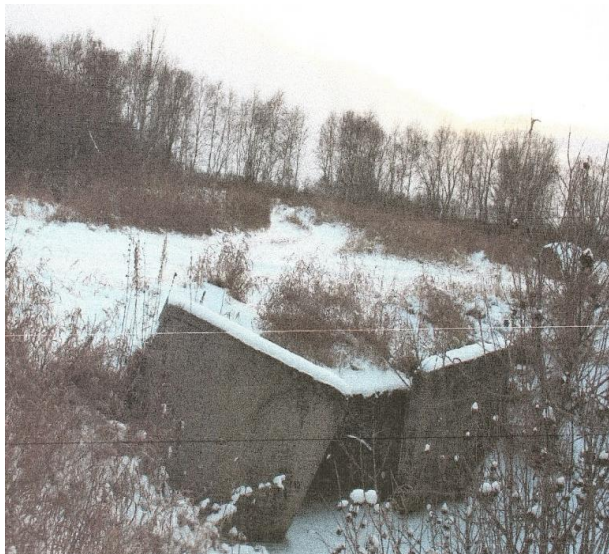
Рисунок 2 – Разрушенный трубчатый переезд на транспортирующем канале
