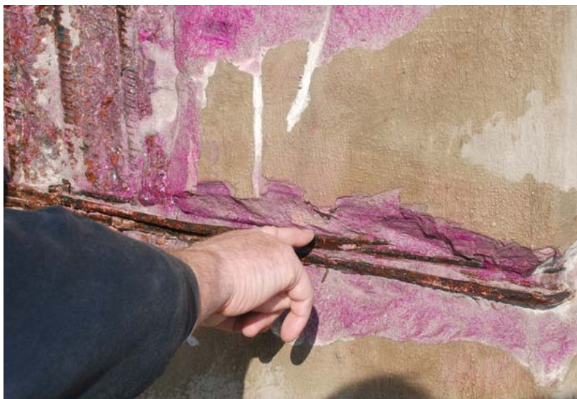
Рисунок 1 – Химическое разрушение бетона
