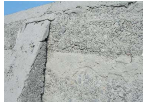
Рисунок 3 – Физическое разрушение бетонных конструкций
