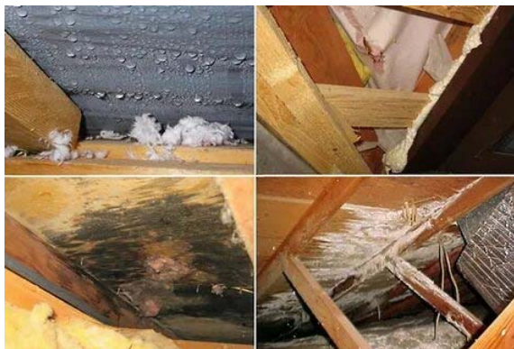
Рис. 1. Дефекты при нарушении строительно-монтажных работ по возведению кровли
