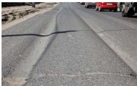
Рис.1 Деформация дорожного полотна
