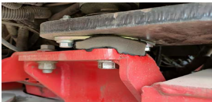
Рисунок 4. Полное разрушение прокладки
